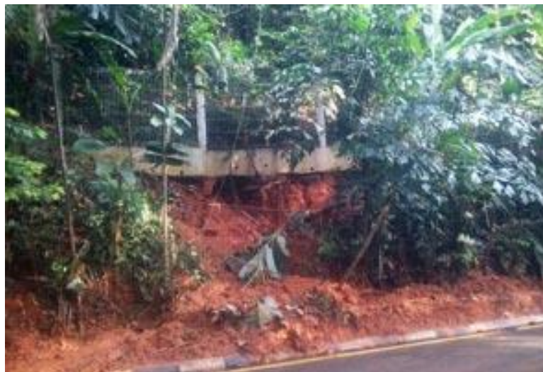
Figure 2.20 Landslide in Bukit Nanas.
